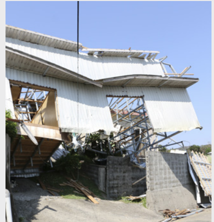
鉄骨が折れ曲がり倒壊した様子。
