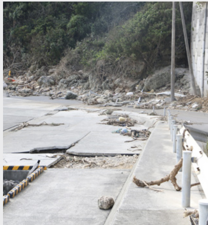
前泊漁港。コンクリートが破壊される。
