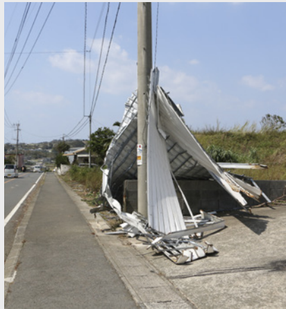
電柱に巻き付く屋根。
