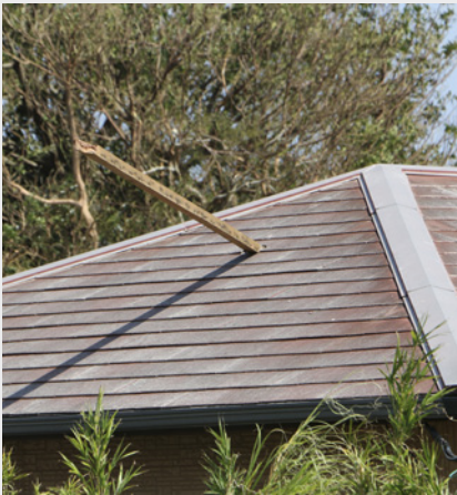
飛散した柱が屋根を貫通。
