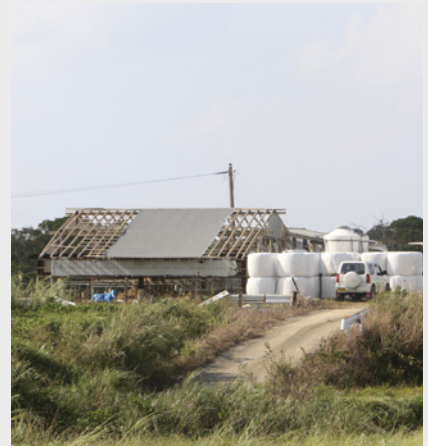
牛舎の屋根が飛ばされる被害。
