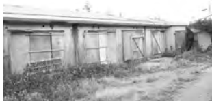
老朽化して、空家となっている町営住宅 (西目手久集落)
