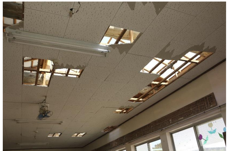
家屋被害の様子
